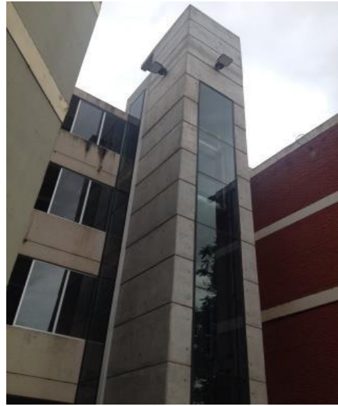
Elevador Edificio D1
