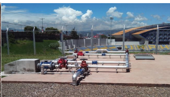
Tubería de impulsión
